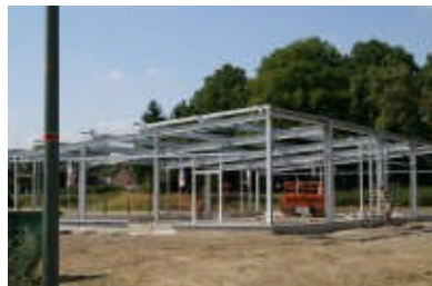
An der Robert-Bosch-Straße entsteht auf 2000 Quadratmetern eine Klinik für Kleintiere. (Foto: Ingel)
